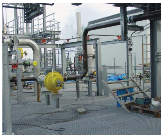
Rohre aus dem Werkstoff 1.4565 im chemischen Betrieb. Foto: Hempel Special Metals GmbH
